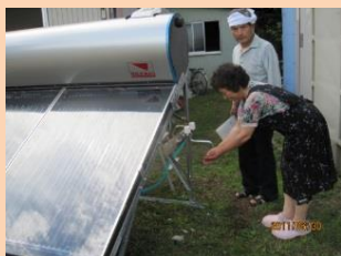
緊急支援では地面置きで46基
